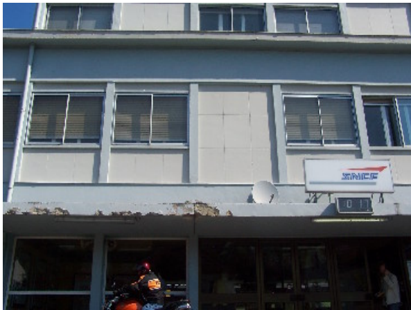
La gare de Béning en piteux état !!
